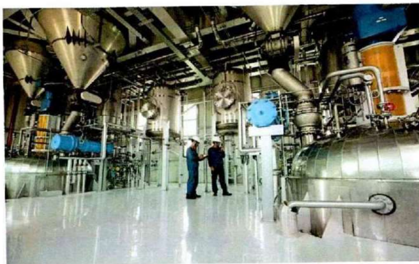
Hình 11: Một khu vực của dây chuyền sản xuất nhựa PEKN công suất 25.000 tấn/năm của Nhà máy sản xuất Hóa chất Phenikaa – Tập đoàn Phenikaa
