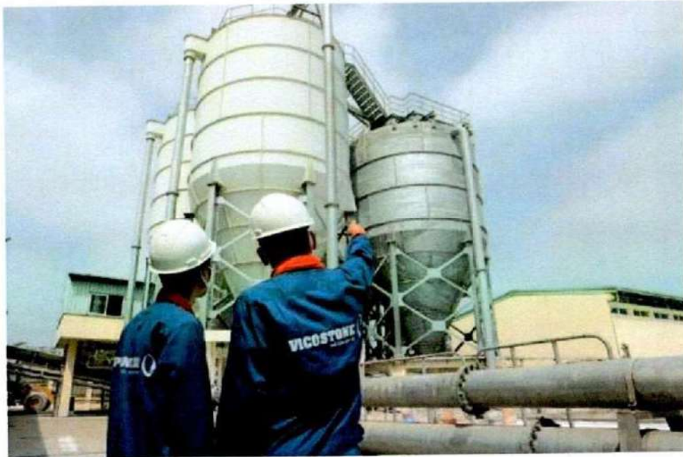
Hình 28: Hình ảnh hệ thống xử lý nước tuần hoàn tại Công ty Cổ phần Vicostone
